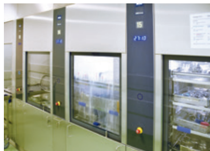
Fünf neue Reinigungsmaschinen können im Caritas-Krankenhaus gleichzeitig beladen werden.
